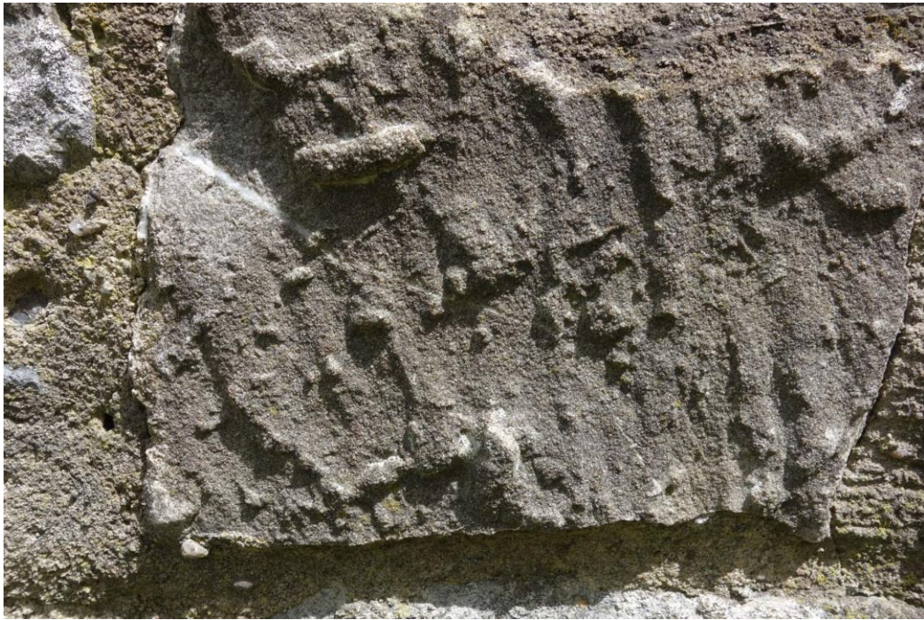
Zed' frýdeckého zámku. Foto A. Uhlíř, květen 2021.
