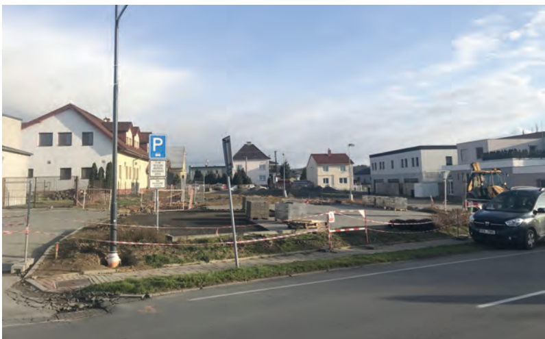
Vodovod a kanalizace centrum
