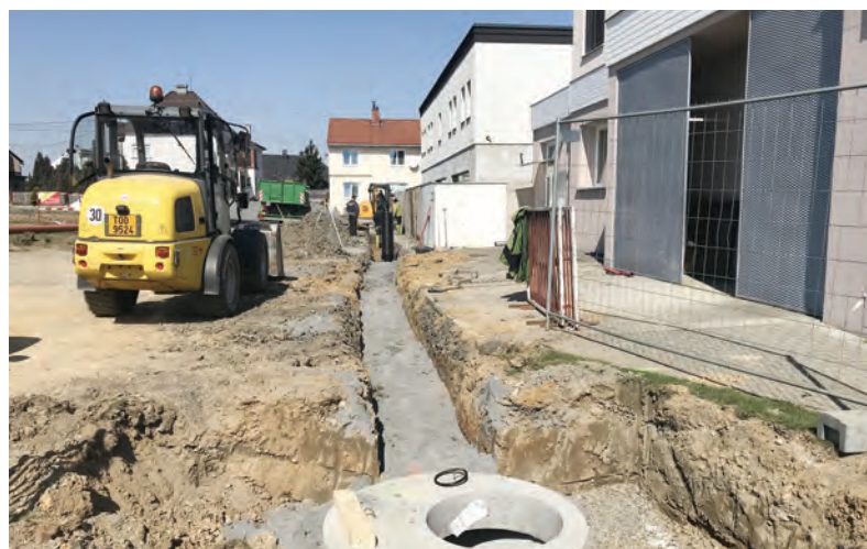
Vodovod a kanalizace centrum
