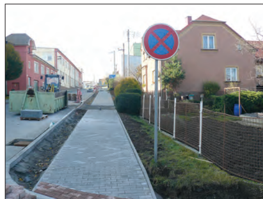
Chodník Opavská ulice
